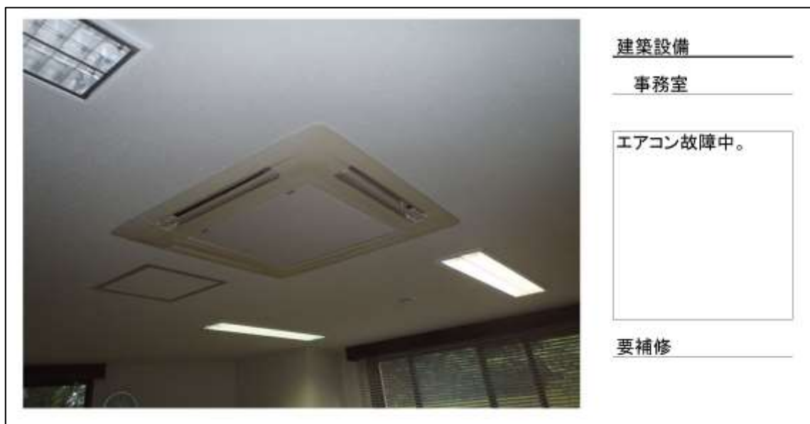
写真 設備・装置等の状況（西部リレーセンター）
