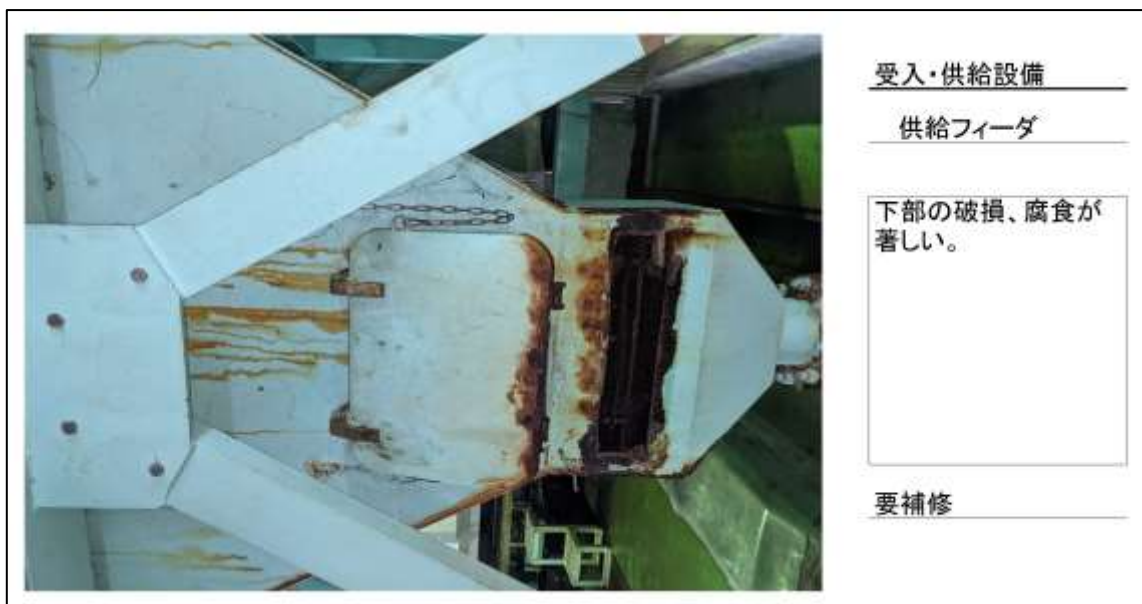
写真 設備・装置等の状況（東部リレーセンター）
